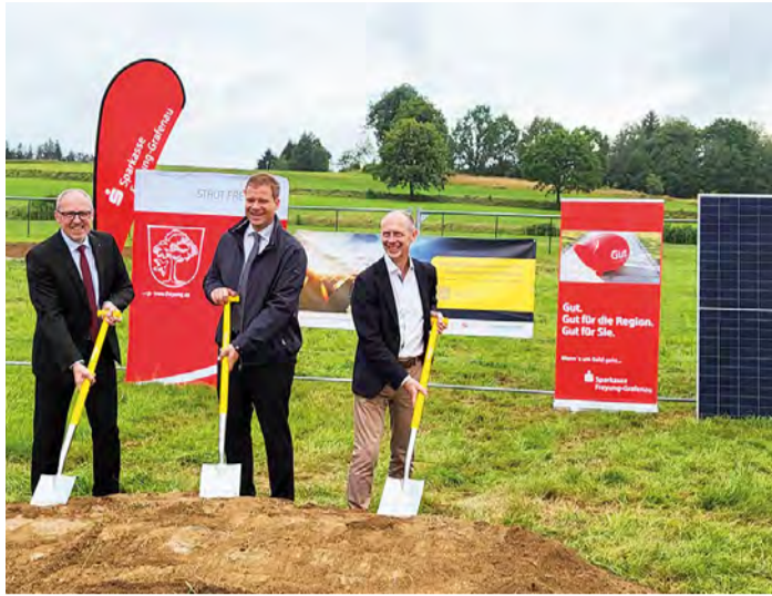
Beim Spatenstich der neuen Solaranlage, v.l.: Dietmar Attenbrunner, Vorstand der Sparkasse Freyung-Grafenau, Bürgermeister Dr. Olaf Heinrich und Dr. Egon Leo Westphal Vorstandsvorsitzender Bayernwerk.
