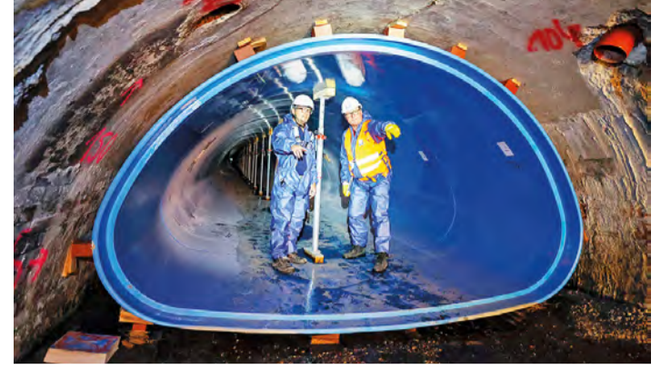
Die GFK-Rohre werden mit Hilfe von Ziegelsteinen und Holzkeilen in ihrer Lage gesichert. Die Baustützen verhindern ein Aufwölben des Sohlbereiches während der Ringraumverdrämmung. Im Gespräch Aarsleff Oberbauleiter Johannes Leewe (l.) und Güteschutz Prüflingenieur Guido Heidbrink (r.). Bild: Güteschutz Kanalbau
