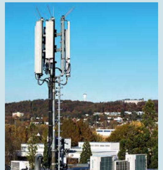
Dachstandort. Foto: Informationszentrum Mobilfunk – Hendrik Zwietsch
