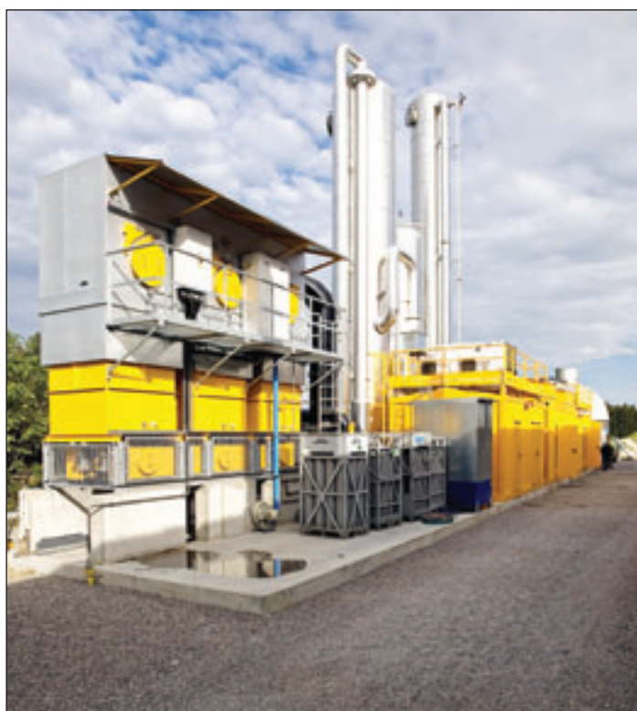
Bioerdgasanlage in Altenstadt.
