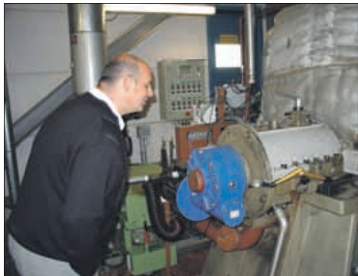
Brey hört ganz genau hin. Die Betriebsgeräusche der Turbine geben Aufschluss über ihren Zustand.
