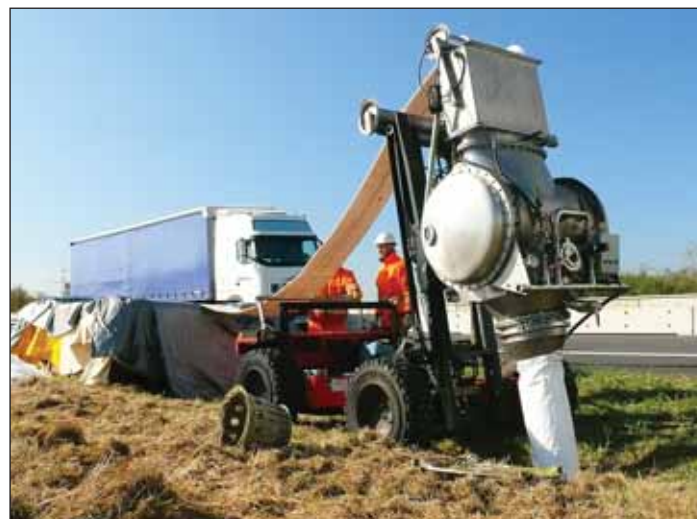
Die Chip-Unit invertiert den Synthesefaserliner mit Luftdruck in das zu sanierende Rohr. Foto: Insitiform GmbH
