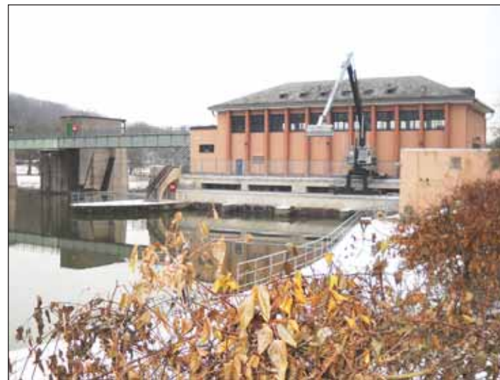
Mit der endgültigen Inbetriebnahme der Hightech-Rechenreinigungsanlage ist das Mainkraftwerk Rothenfels wieder optimal fit zur Erzeugung regenerativen Stroms aus der Kraft des Mains. Foto: Jan Kiver, Rhein-Main-Donau AG
