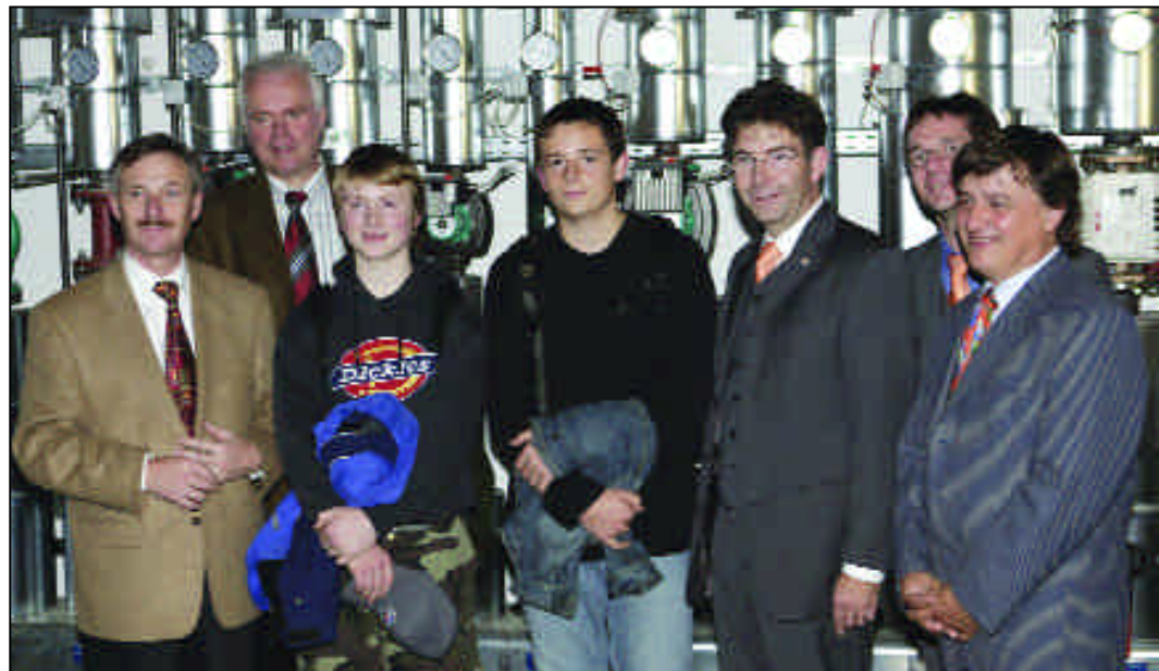
Landrat Luitpold Braun (links) begutachtete gemeinsam mit Repräsentanten der ESB und des Schulzentrums die ausgefeilte Technik, die im Weilheimer Schul- und Sportzentrum Energie und Wärme liefert. Foto: ESB
