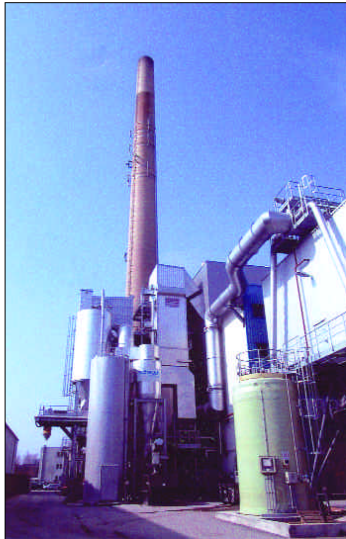
Im neuen Biomasse-Heizkraftwerk in Neufahrn werden künftig jährlich 40.000 Tonnen Holzhackschnitzel verarbeitet.
