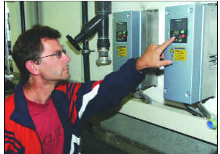
Betriebsleiter Erich Gottwald lüftet das Geheimnis um das „Energiesparwunder“ im Burgkirchener Bad: Zwei Frequenzumformer mit Computersteuerung. Foto: Gerlitz
