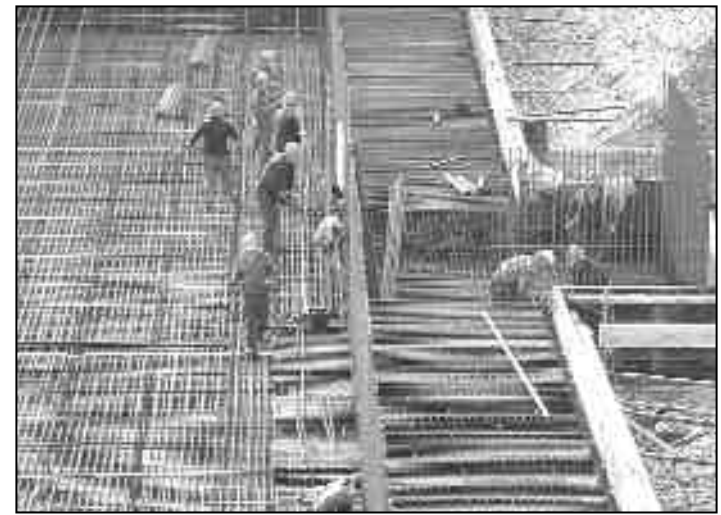
Bauarbeiter im neuen Gewerbepark Breisgau: Aus Beton und Bewehrungsstahl entsteht das Fundament der künftigen Abfallentsorgung der Region.
